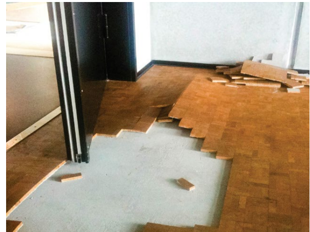
Undgå fugtrelaterede byggeskader i gulvbelægningen som dampbuler eller mangelfuld vedhæftning
